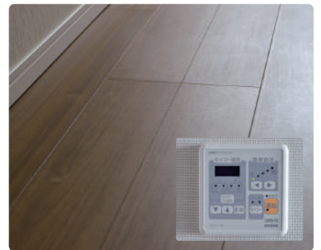
全室に床暖房を完備
