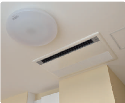
埋め込み式のエアコンですっきりと
